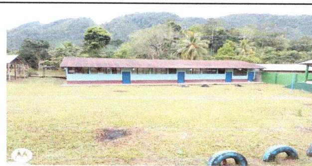
Foto 5: se observa la deterioro del techo del establecimiento
