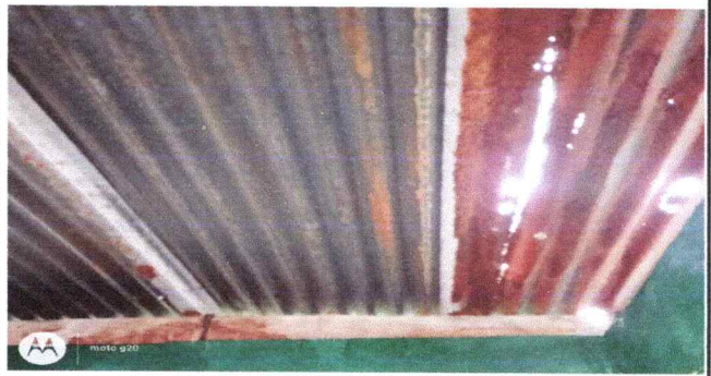
Foto 4: se observa el deterioro del techo del establecimiento
