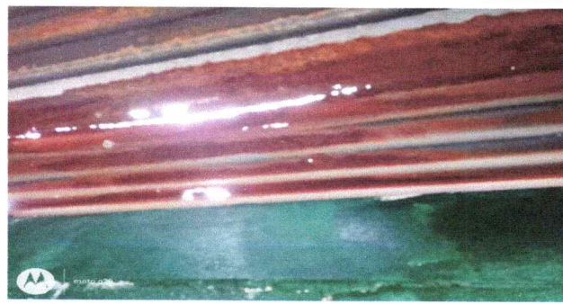
Foto 3: se observa el deterioro del techo del establecimiento
